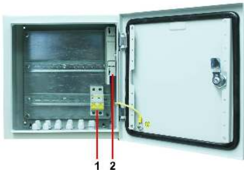
Рис.21 Уличная станция OS-331, внутренние элементы
