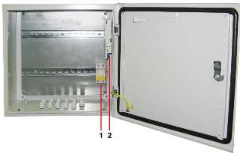
Рис.11 Уличная станция OS-441, внутренние элементы
