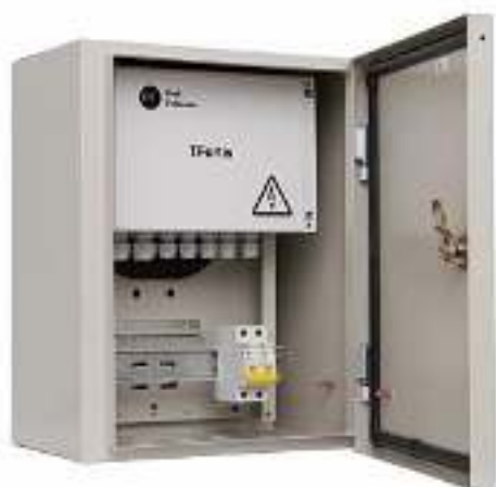
Рис. 6.1.3-1. Шкаф TFortis CrossBox-1 с коммутатором PSW-2G4F
