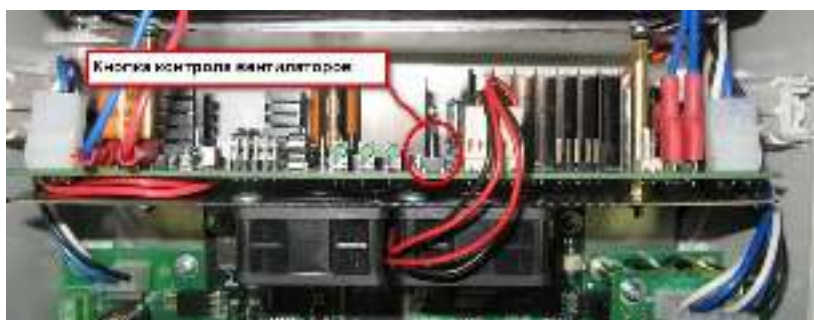
Рис. 2.9.6. Проверка работоспособности вентиляторов.
